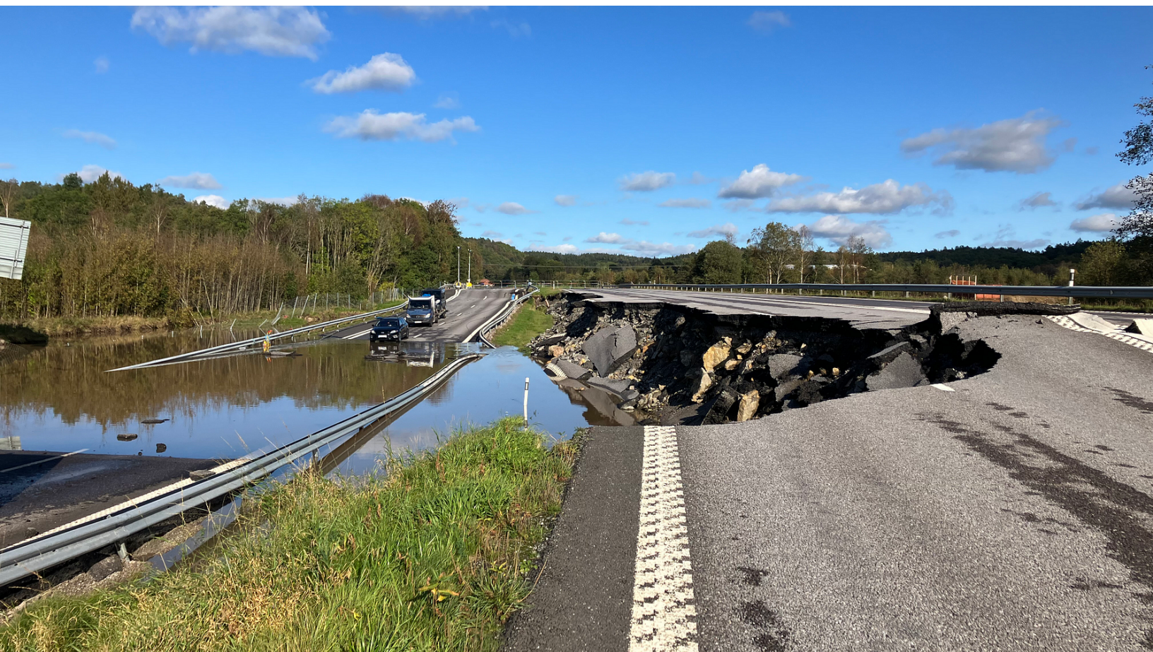
Jordskredet i Stenungsund 2023. Foto: Jonas Axelsson, Trafikverket.
